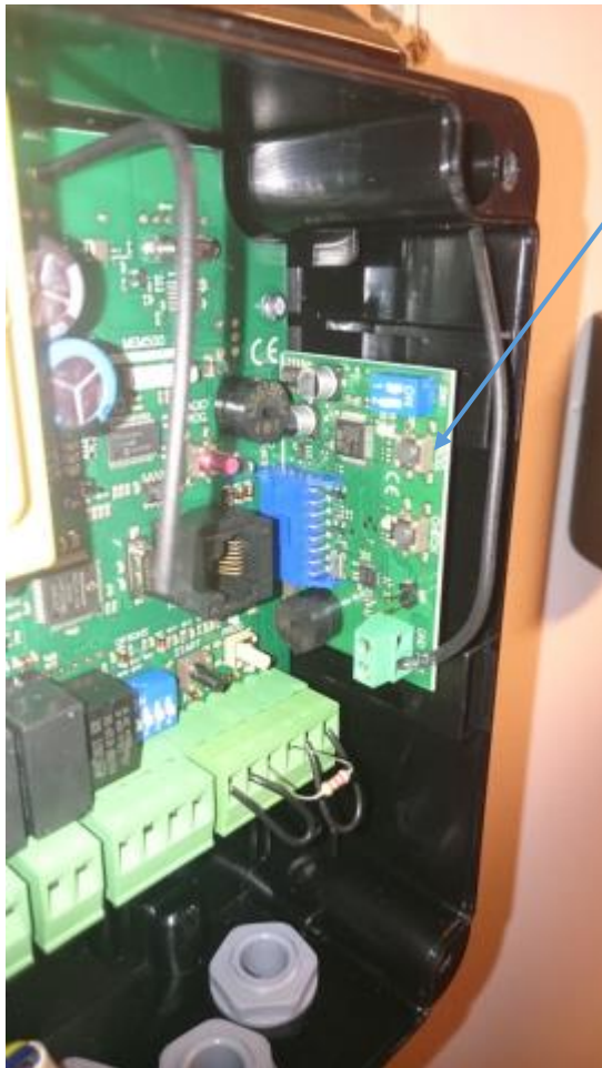
Kretskort styringskap for DMS (er til høyre) Se Punkt 7
